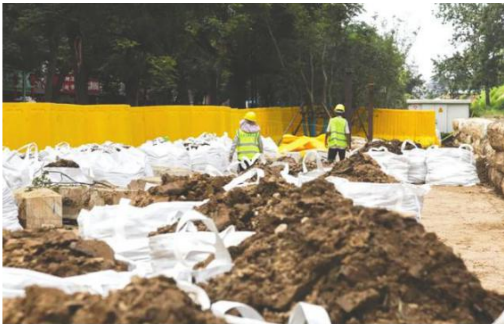
施工现场摆满了古城墙滑坡产生的泥土 每经记者 韩阳 摄
